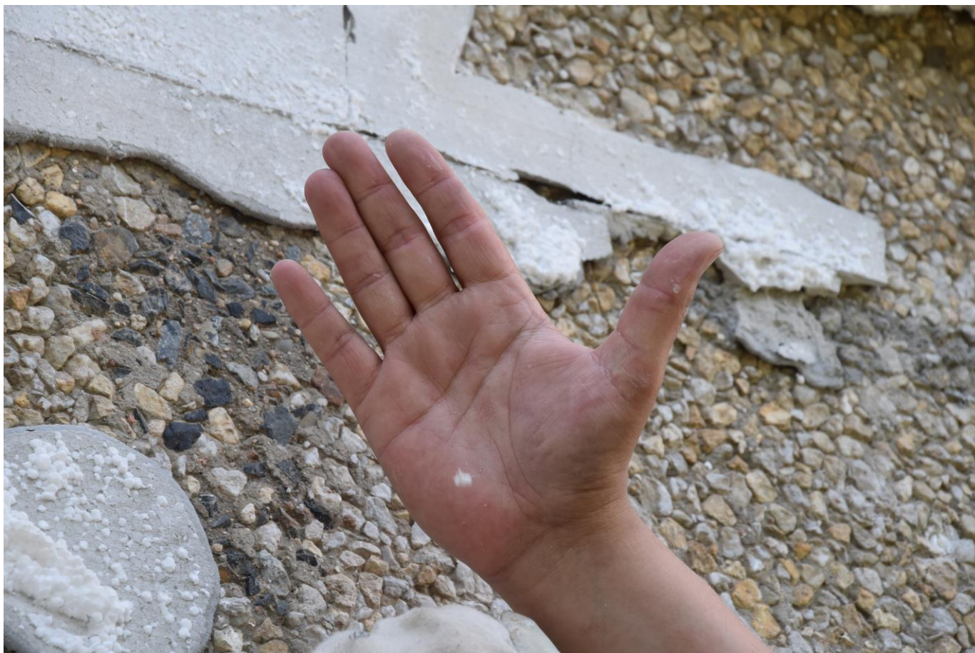
Detail – mírné špinění podkladního betonového panelu.
