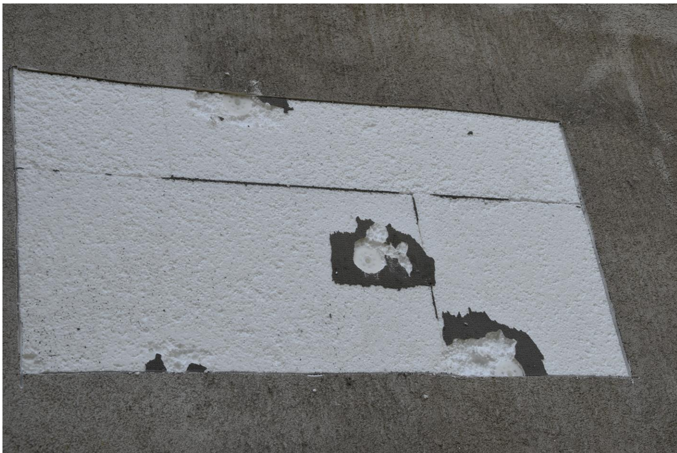
Detail – počet hmoždinek v odkrytém místě sondy 3 ks.
